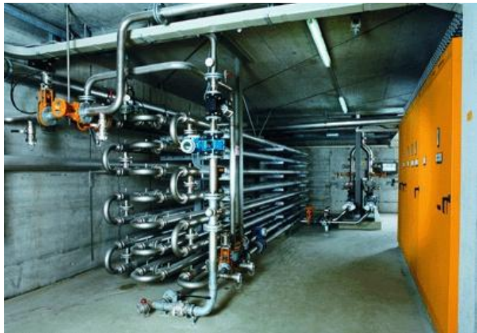
Figure 27 : Echangeur tubulaire en sortie de STEP (Lyonnaise des Eaux, ISTINOX, ANTEA)
