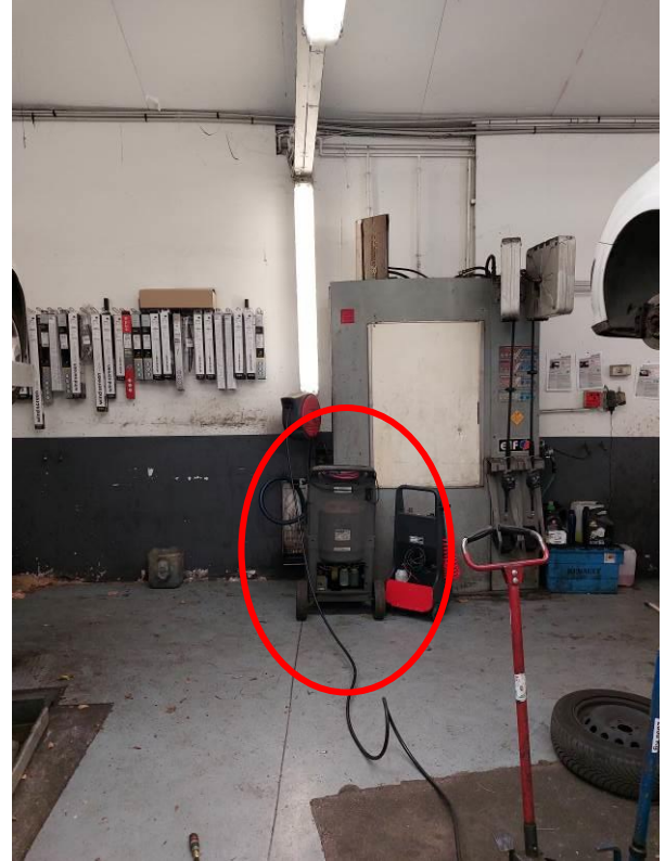
Station de recharge de climatisation et fuite de traceur
