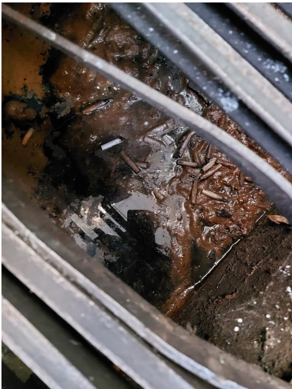
Produits flottant dans le bac de rétention d'eau de l'air de lavage
